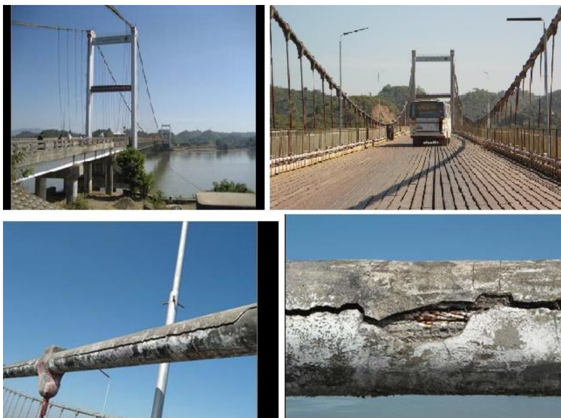
Рисунок 13. Техническое состояние висячего моста «Ярмаунг» (фото авторов)
