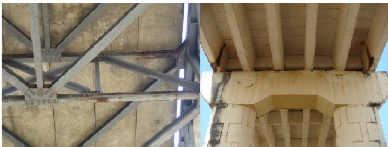
Рисунок 15. Состояние моста «Твантей» (фото авторов)
