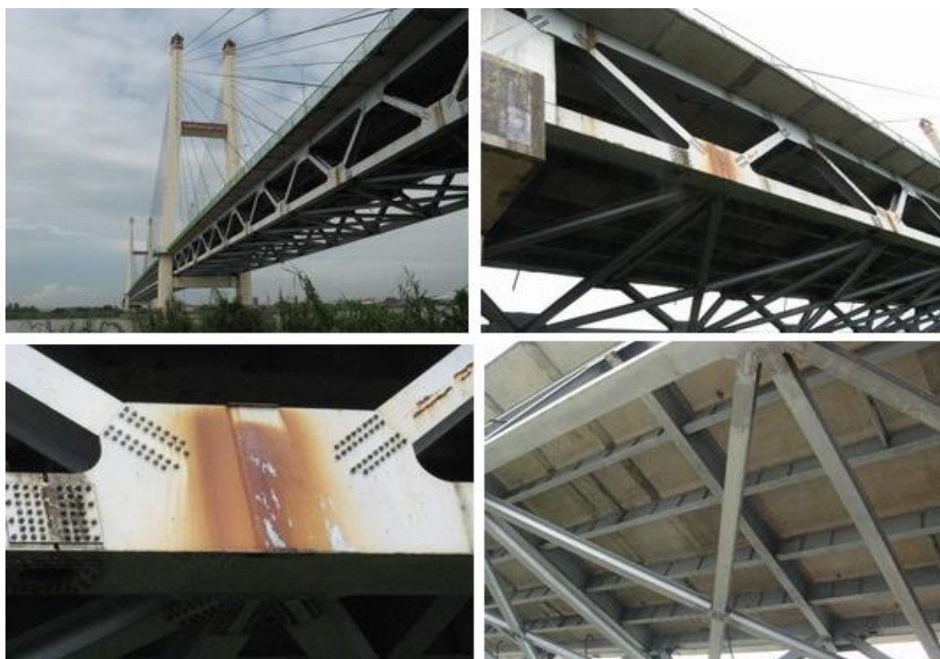
Рисунок 11. Повреждения элементов пролетного строения моста Аунг Зайяр (фото авторов)
