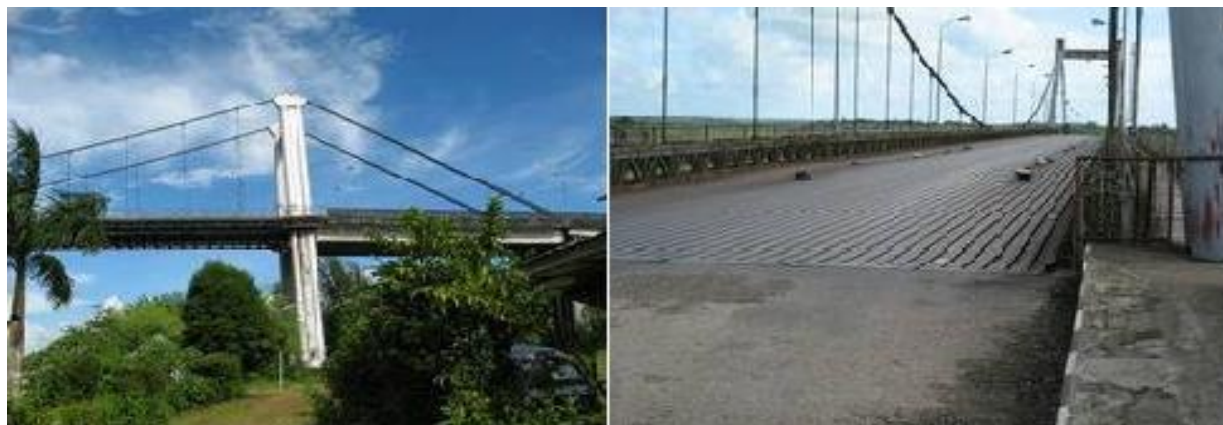
Рисунок 12. Техническое состояние висячего моста Мяунмя (фото авторов)
