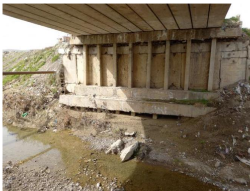
Рисунок 4. Размыв береговой опоры моста через реку Сангзар [10]
