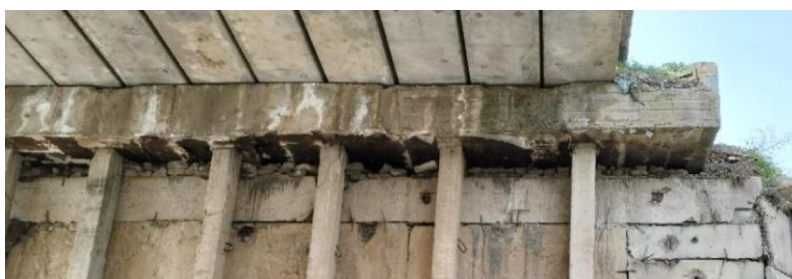
Рисунок 6. Замачивание ригеля мостовой опоры из-за нарушения водоотвода [10]
