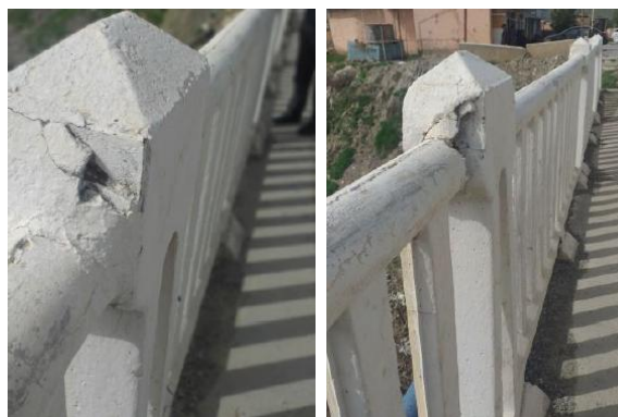
Рисунок 7. Пример повреждения железобетонных перильных ограждений моста [10]
