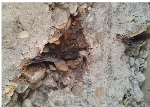
Рисунок 5. Отслоение защитного слоя бетона и коррозия арматуры, вызванные совместным действием хлоридов и карбонизации [10]
