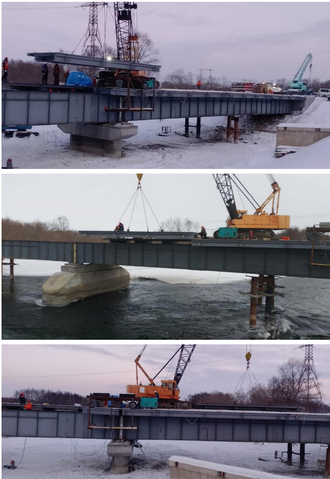
Рисунок 26. Монтаж блоков ортотропных плит на пролетных строениях моста через реку Быстрая стреловым краном с помощью временной опоры (фото автора)
