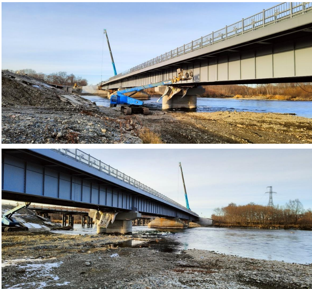
Рисунок 27. Общий вид фасада металлических пролетных строений моста через реку Быстрая (фото автора)
