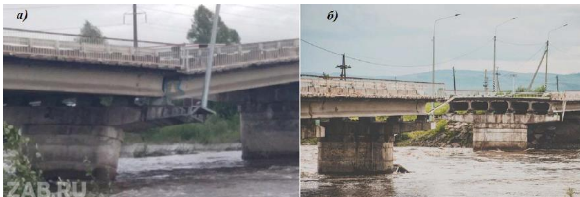
Рисунок 6. Разрушение Каштакского моста: a — крен опоры; б — обрушение пролета [16]
