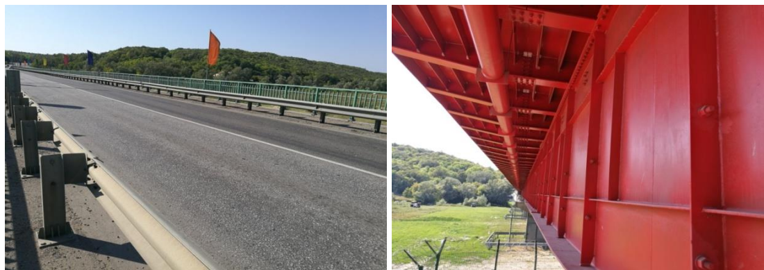
а) б) Рисунок 2. Измеряемые элементы пролетного строения: а) асфальтобетонное покрытие; б) главные балки
