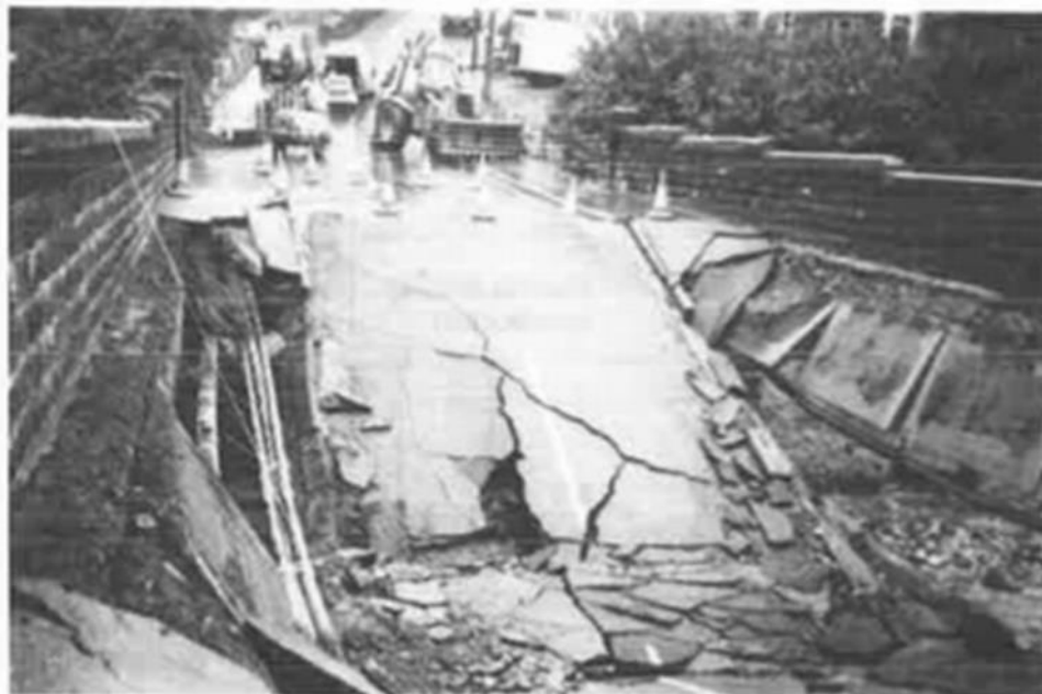
Рисунок 1. Крушение автодорожного моста в Южном Уэльсе Западный Гламорган, Великобритания (источник: https://link.springer.com )
