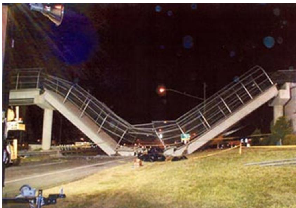
Рисунок 2. Обрушение пешеходного моста в городе Конкорд, США (источник: https://www.nace.org )
