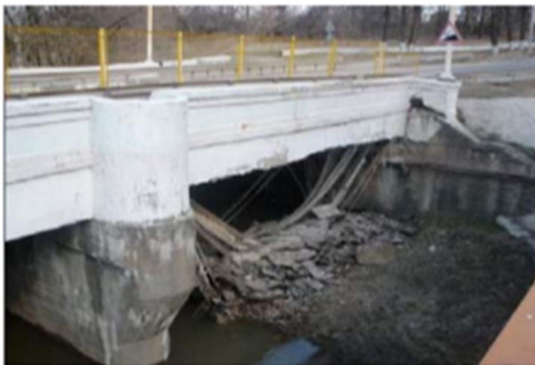
Рисунок 4. Обрушение моста в Екатеринбурге, Россия (источник: http://eadnurt.diit.edu.ua )
