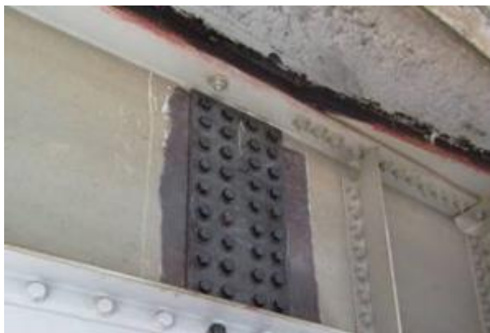
Рисунок 1. Ремонт стенки с усталостной трещиной (взято из реестра усталостных трещин ОАО «РЖД»)
