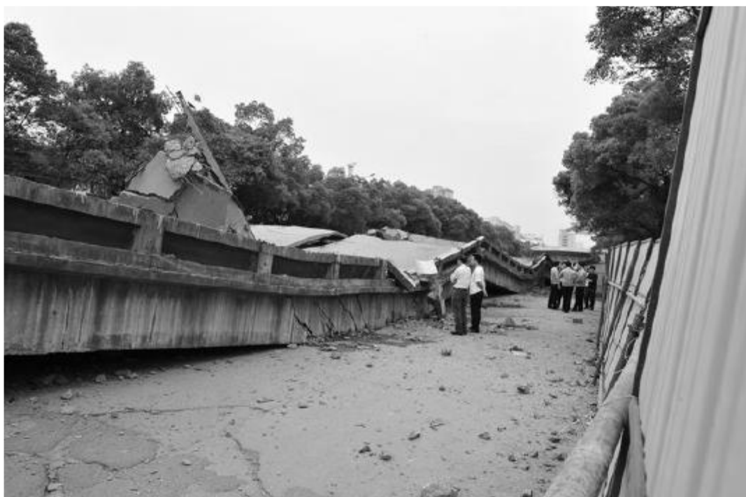
Рисунок 6. Разрушение виадука в Китае [35]
