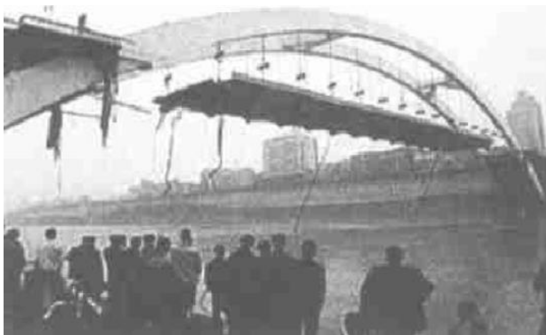
Рисунок 5. Разрушение арочного моста в провинции Сычуань. Видны порвавшиеся подвески [36]
