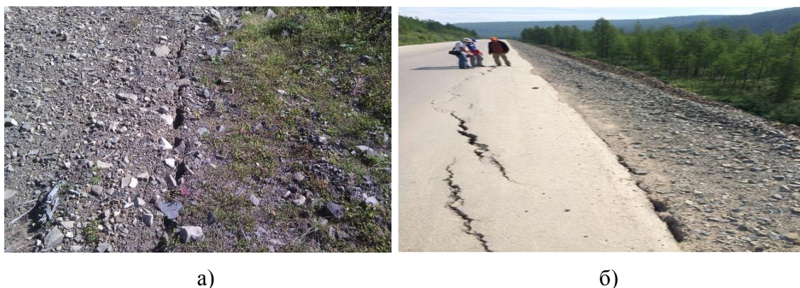
Рисунок 3. Вертикальные трещины за бровкой в грунтовых телах: а) выемки; б) насыпи с асфальтобетонным покрытием на 451–452 км федеральной автодороги «Лена» (фото С.М. Ждановой)
