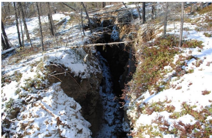
Рисунок 11. Вид грунтового массива за левой бровкой глубокой выемки на 451–452 км федеральной автодороги «Лена» (фото С.М. Ждановой)
