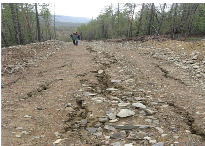
Рисунок 10. Трещины на поверхности обездвиженной грунтовой дороги за бровкой глубокой выемки, расположенной на 451–452 км федеральной автодороги «Лена» (фото С.М. Ждановой)
