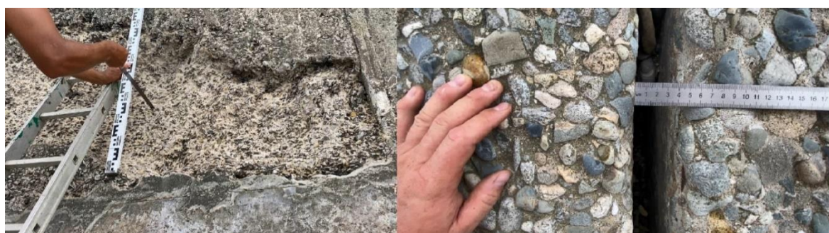
Рисунок 6. Примеры значительных дефектов волноотбойных стен, защищающих земляное полотно железных дорог (разработано автором)
