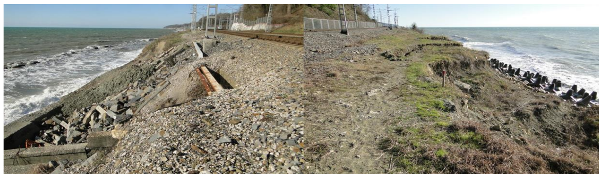
Рисунок 5. Примеры критических дефектов сооружений инженерной защиты земляного полотна железных дорог (фото автора)
