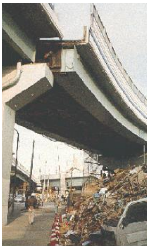
Рисунок 9. Смещение пролета моста в результате повреждения опорной части [38]
