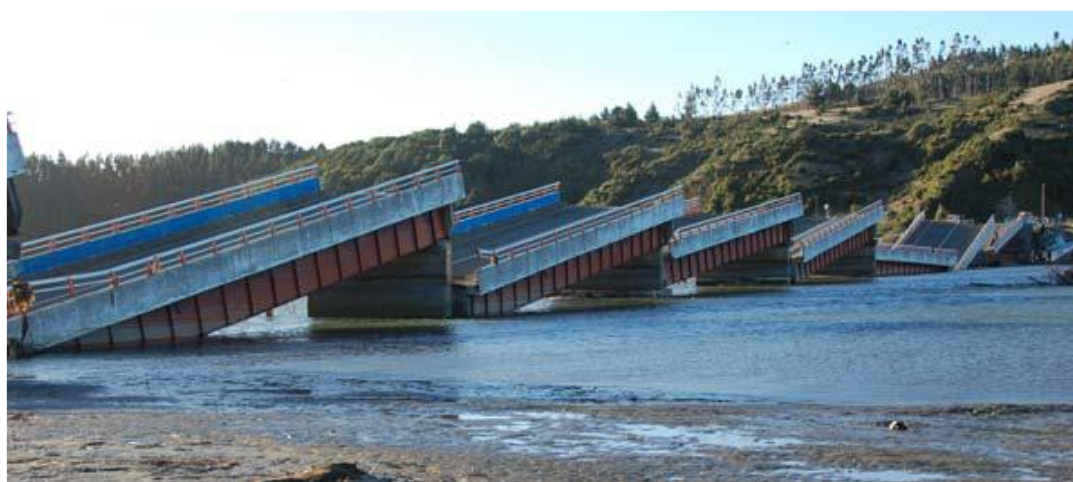
Рисунок 11. Обрушение моста в городе Арауко, Чили [39]
