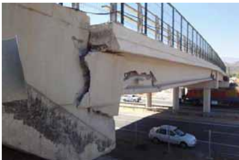
Рисунок 10. Повреждение устоя и пролета путепровода в Чили (источник: Rafferty, John P. and Pallardy, Richard. «Chile earthquake of 2010». Encyclopedia Britannica, 20 Feb. 2024, URL: https://www.britannica.com/event/Chile-earthquake-of-2010 , фото: National Technical Information Service)
