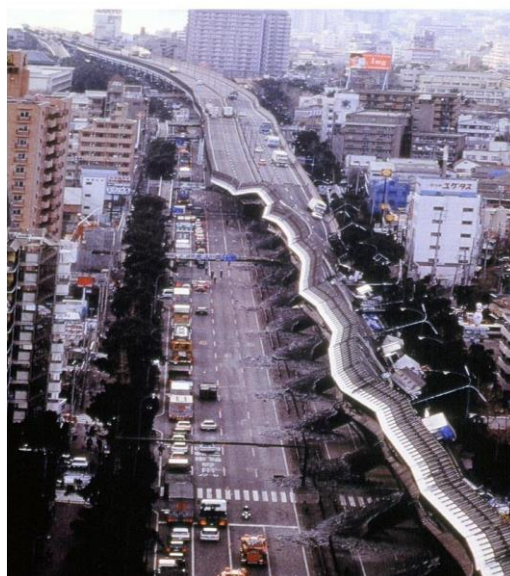
Рисунок 8. Обрушение эстакады Хансин [36]
