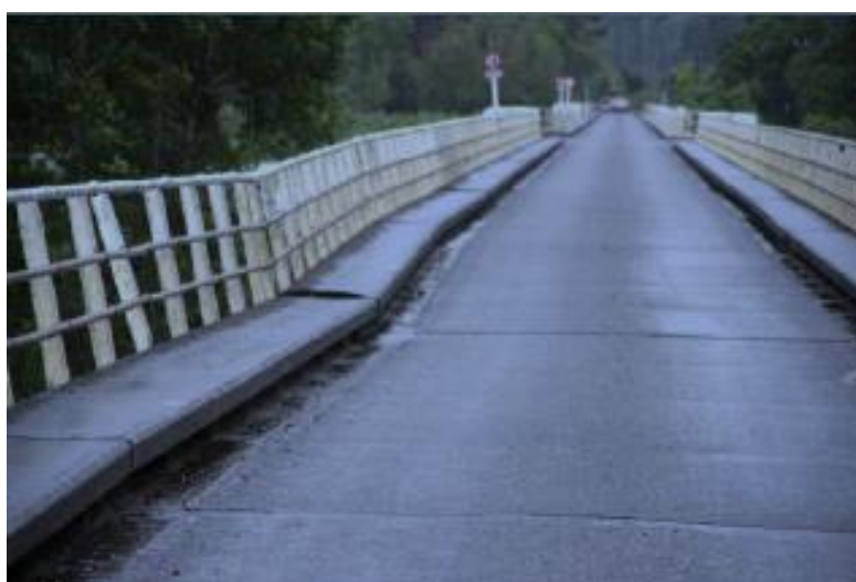
Рисунок 7. Искривление пролетов моста через реку Вайау [34]
