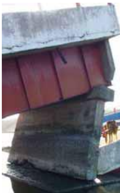
Рисунок 12. Вид опоры моста в городе Арауко в Чили после землетрясения (источник: https://www.fhwa.dot.gov/publications/research/infrastructure/structures/11030/004.cfm#:~:text=The%20Tubul%20bridge%20is%20an,diaphragm%20and%20the%20wall%20pier , фото: National Technical Information Service)
