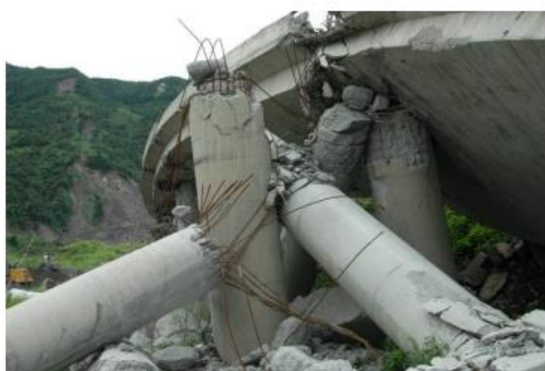
Рисунок 5. Вид опор обрушившихся пролетов [32]
