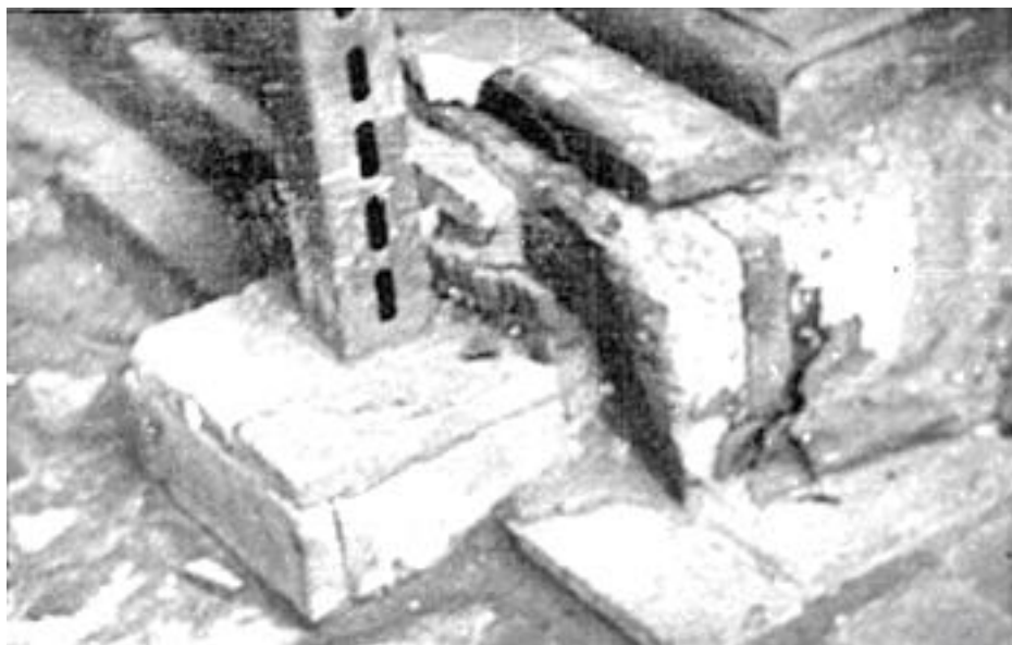
Рисунок 4. Разрушение фундаментов под выпарными аппаратами (цех производства этиленгликоля) (фото автора)
