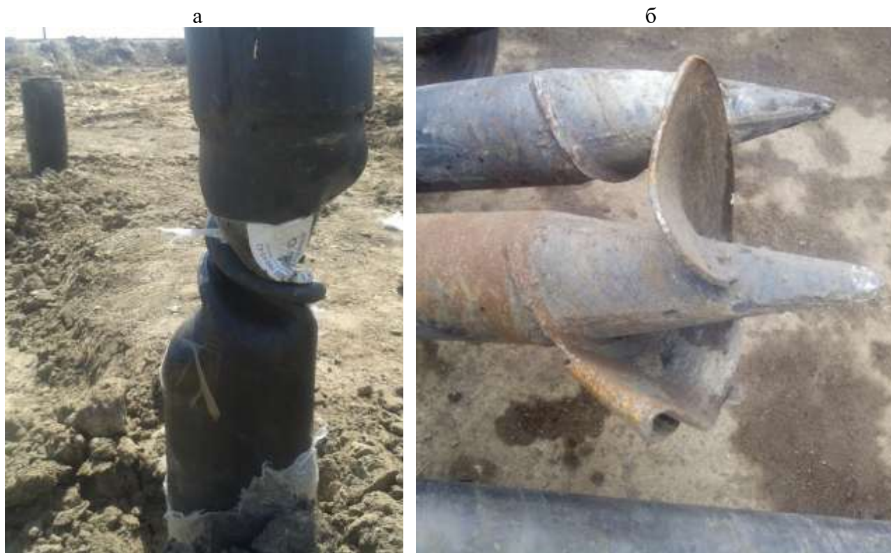
Рисунок 1. Пример повреждения свай при их погружении: а — ствол винтовой сваи; б — лопасти винтовых свай (фото автора)
