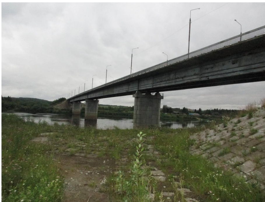
Рисунок 1. Общий вид мостового перехода с левой стороны от конца сооружения (разработано авторами при выполнении натурного обследования)
