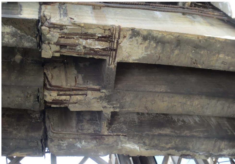
Рисунок 1. Пролет 2. Диафрагма между балками 2 и 3. Обнажение и коррозия арматуры. Разрушение бетона в ребрах балок (снизу) с обнажением и коррозией арматуры (фото выполнено авторами)
