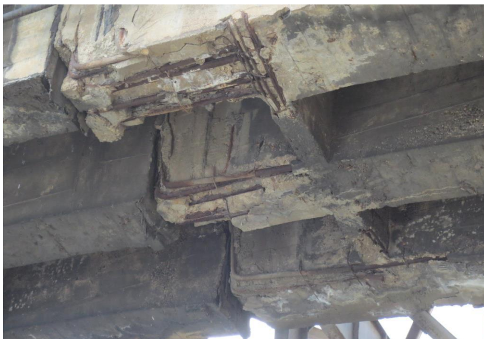
Рисунок 5. Пролет 2. Главные балки 1, 2, 3. Обнажение и коррозия арматуры нижнего пояса и боковых поверхностей балок. Разрушение бетона на глубину до 10 см в стыках балок (фото выполнено авторами)
