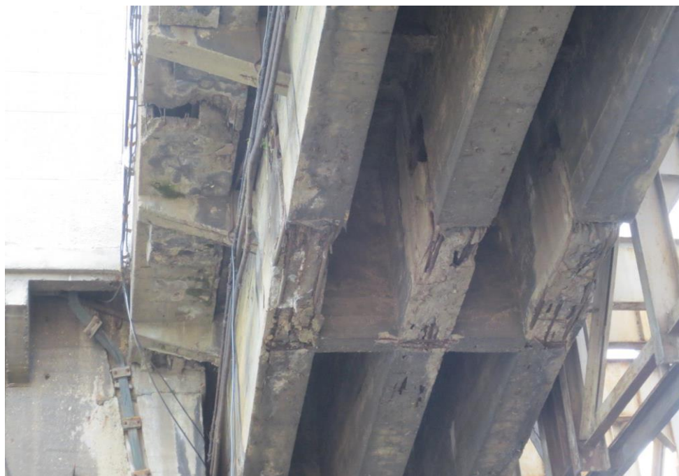
Рисунок 6. Пролет 4. Главная балка 1. Обрыв арматурных стержней, размораживание бетона на глубину 0,2 м и площадью 8,0 м 2 в приопорной зоне (фото выполнено авторами)
