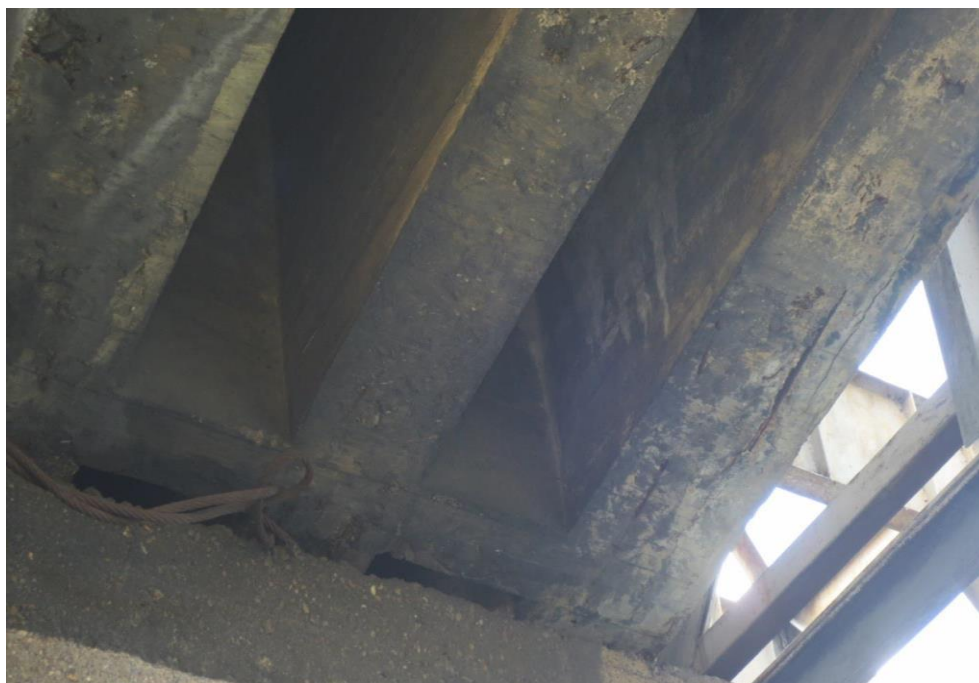
Рисунок 4. Пролет 3. Главная балка 3. Приопорная зона. Трещины с шириной раскрытия 0,3 мм F = 0,7 \times 0,5 м (фото выполнено авторами)
