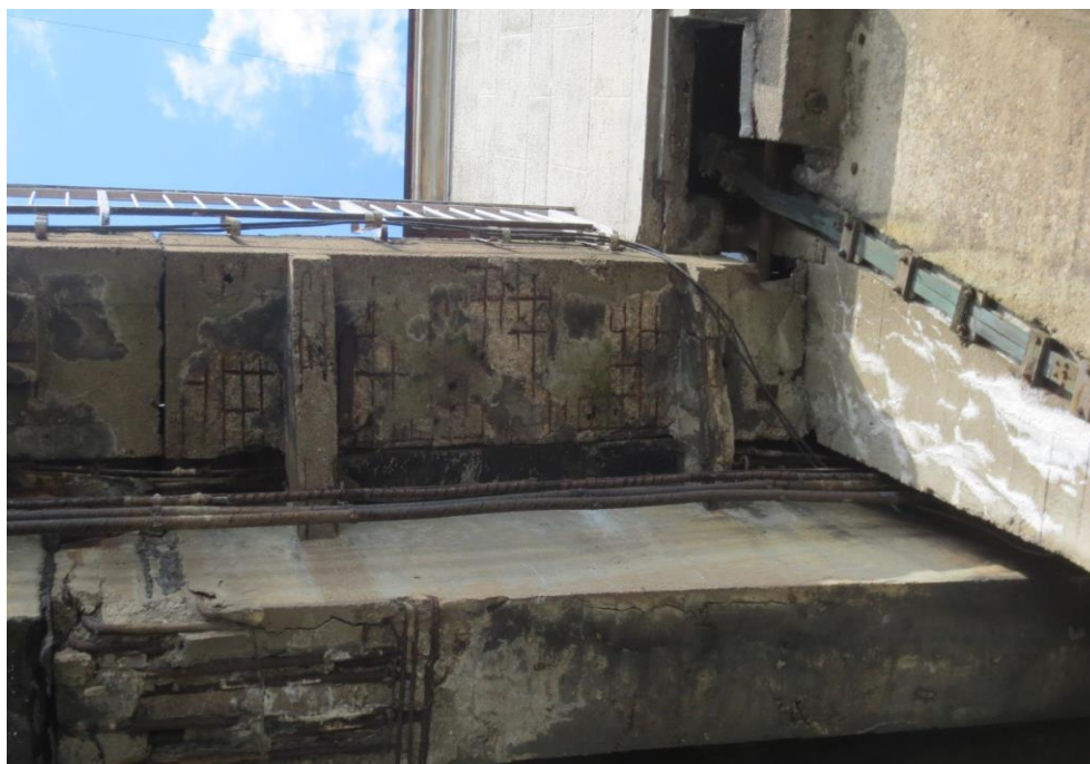
Рисунок 2. Пролет 2. Тротуарная плита. Обнажение и коррозия арматуры, сетка трещин, следы размораживания бетона (фото выполнено авторами)
