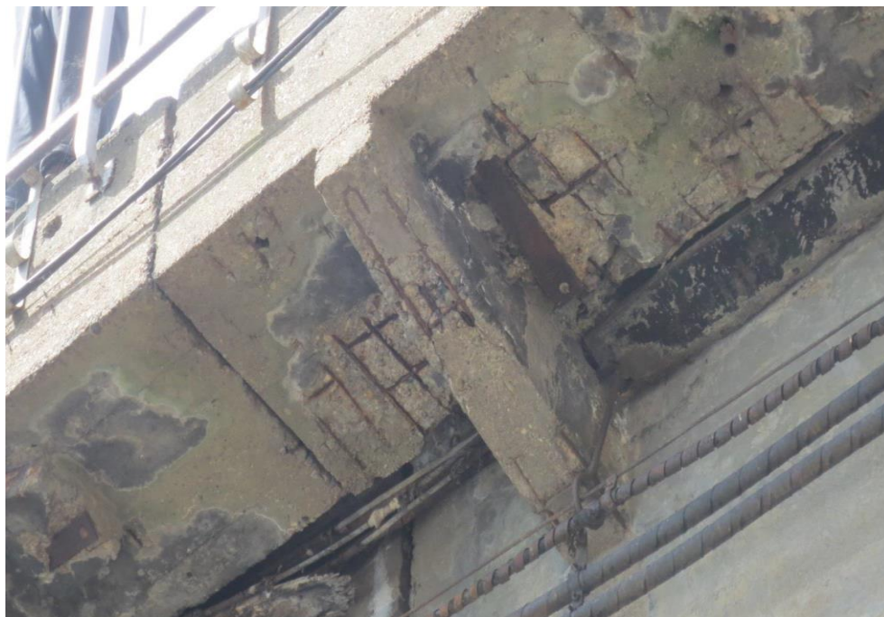
Рисунок 3. Пролет 2. Тротуарная плита. Водоотводной лоток. Разрушение бетона, сеть трещин разрушение дна лотка (фото выполнено авторами)
