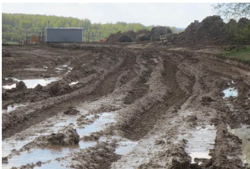
Рисунок 5. Основание на участке №3 разрушено полностью
