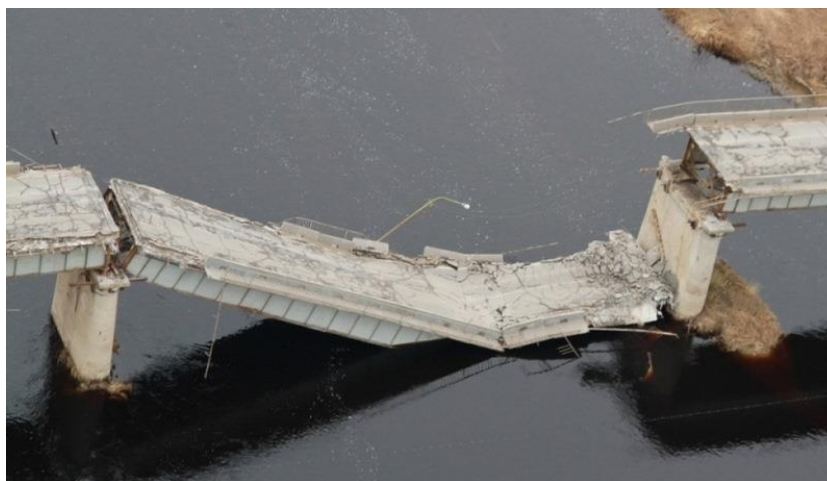
Рисунок 1. Обрушившееся пролетное строение моста через реку Вага (источник: https://www.drive2.ru/c/2440599/ ) 3
