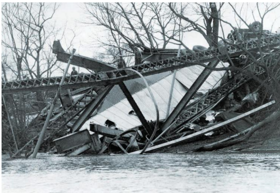
Рисунок 7. Обрушение серебряного моста в Огайо (изображение из материалов Witcher, T.R. «From Disaster to Prevention: The Silver Bridge» [21])
