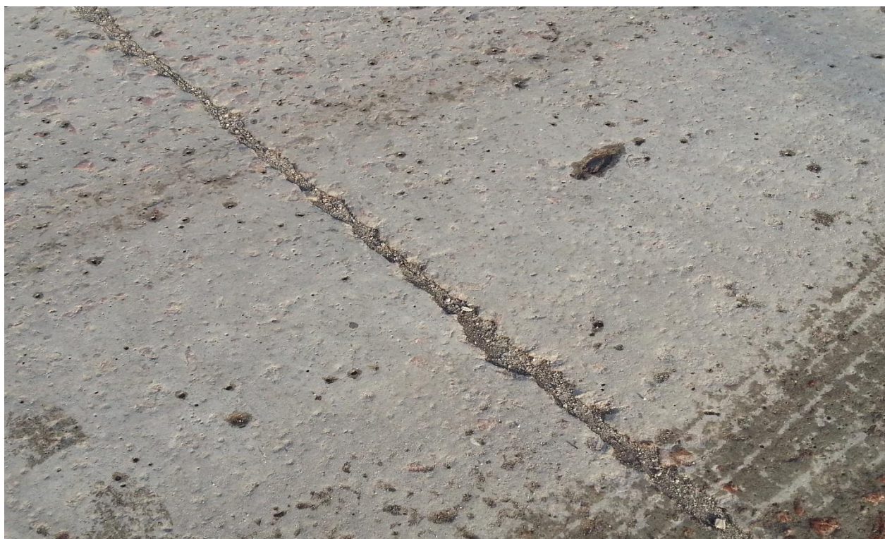
Рисунок 2. Внешний вид старого цементобетонного покрытия и шов расширения, не заполненный мастикой, с фрагментами разрушения на улице города Жуковка Брянской области (разработан авторами)
