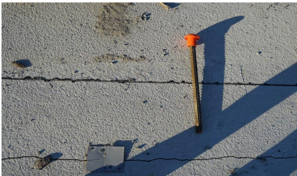
Рисунок 3. Внешний вид трещины возле шва расширения в цементобетонном покрытии и арматурного стержня периодического профиля с полиэтиленовым колпачком (разработан авторами)
