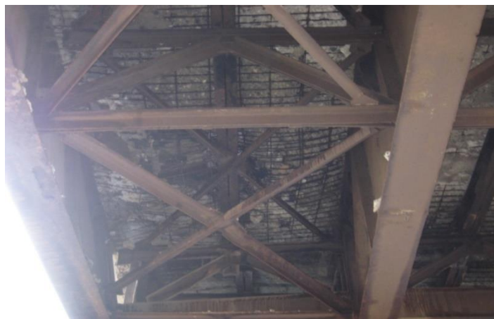
Рисунок 2. Обнажение и коррозия арматуры в плите проезжей части (мост ч/р Сунжа в г. Грозный)
