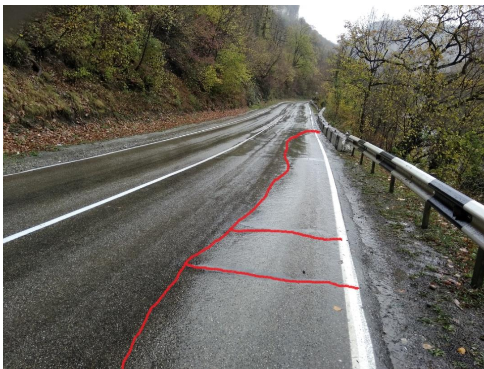
Рисунок 12. Деформации проезжей части на участке автомобильной дороги А-159 Майкоп — Гузерипль, км 43+064 — км 43+107 (разработано автором)
