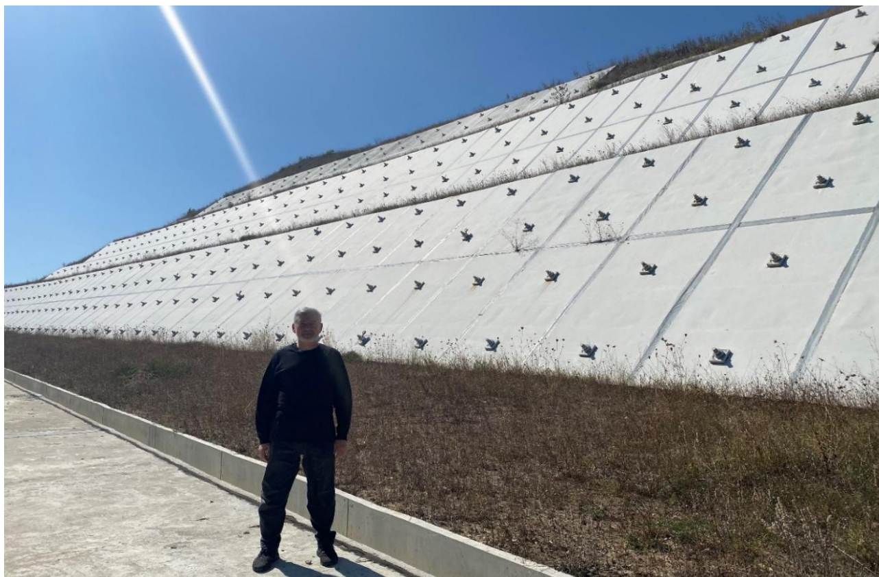
Рисунок 5. Элементы плитно-анкерного противооползневого сооружения на участке 2 (ПК52 + 22,01 — ПК53 + 95,32) трассы «Таврида» (фото автора)
