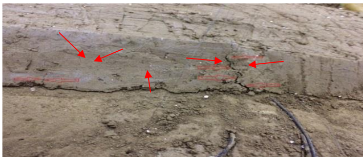
Рисунок 7. Трещины в откосной части земляного полотна автомобильной дороги (рисунок выполнен авторами)
