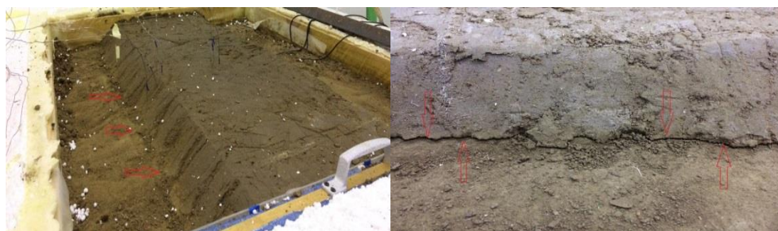
Рисунок 6. Отслоение откосной части земляного полотна от основания автомобильной дороги (рисунок выполнен авторами)
