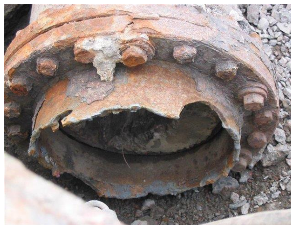
Рисунок 6. Коррозия зоны опирания опоры освещения (фото авторов) Figure 6. Corrosion of the illumination pole support zone (the authors' photo)
