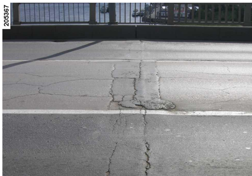
Рисунок 4. Разрушение покрытия проезжей части на балочных пролетных строениях в районе деформационного шва над опорой 5 (фото авторов)
