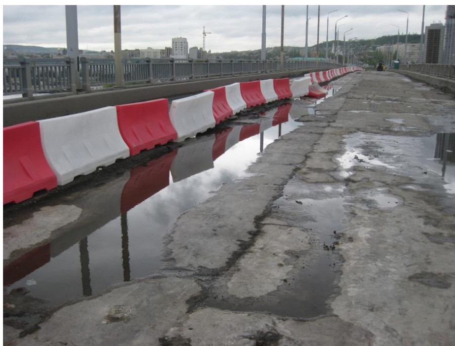
Рисунок 7. Очень неровная поверхность плиты проезжей части после снятия старого слоя дорожной одежды (фото авторов)
