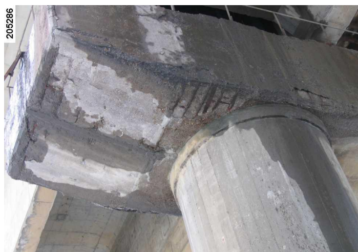
Рисунок 2. Разрушение защитного слоя ригеля опоры 18 вследствие систематического увлажнения через деформационный шов (фото авторов)
