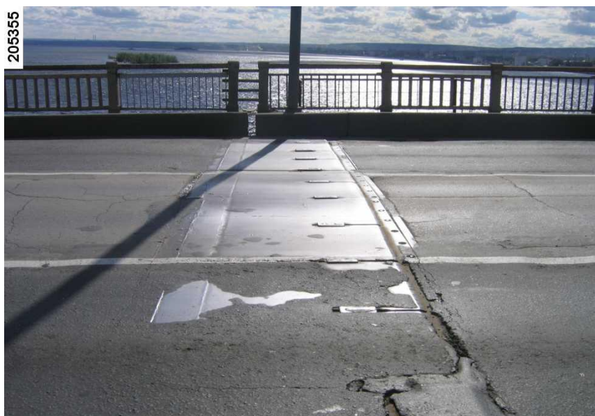
Рисунок 3. Разрушение покрытия проезжей части в месте сопряжения неразрезного и разрезного пролетного строения в районе деформационного шва над опорой 11 (фото авторов)
