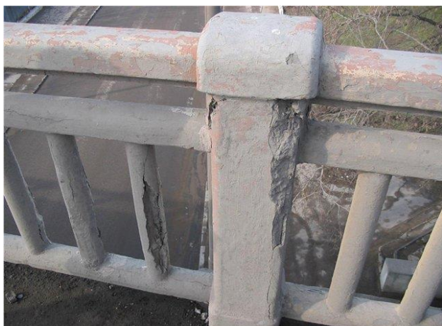
Рисунок 5. Коррозионные повреждения перильных ограждений (фото авторов) Figure 5. Corrosive damages of railings (the authors' photo)
