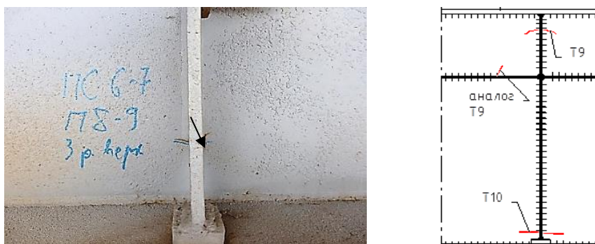
Рисунок 1. Трещины в железнодорожных пролётных строениях (фото авторов)
