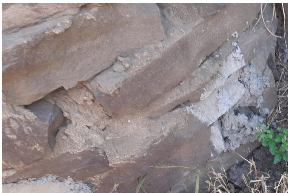
Рисунок 3. Разрушения каменной кладки подпорной стены (фото авторов)
