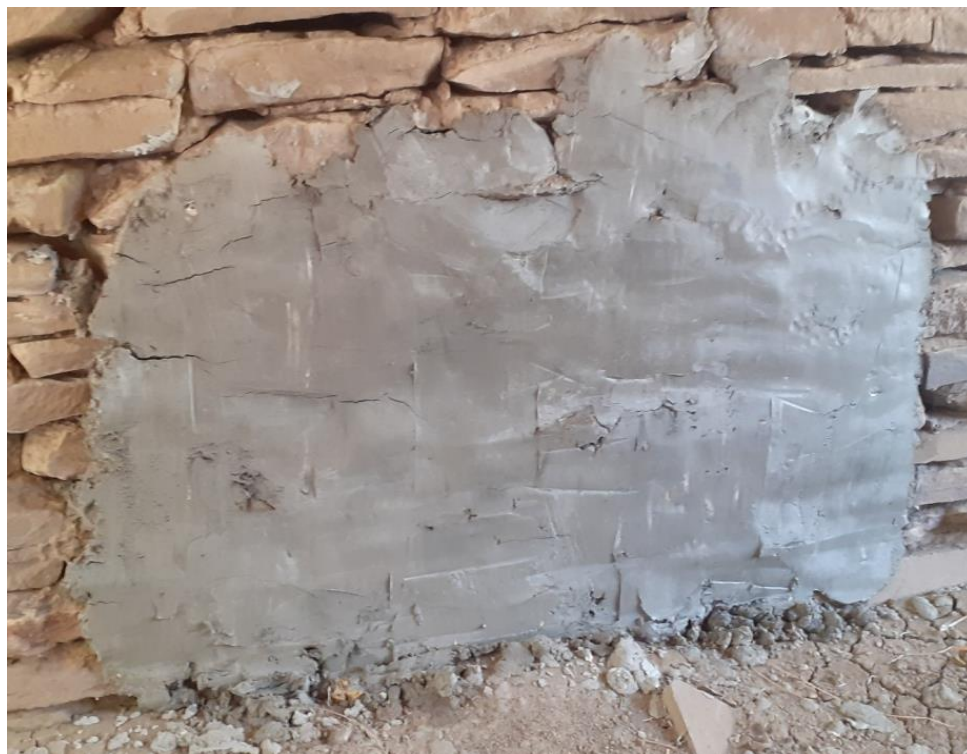
Рисунок 5. Усадочные трещины для смеси цемента с просеянным ПГС (фото авторов)
