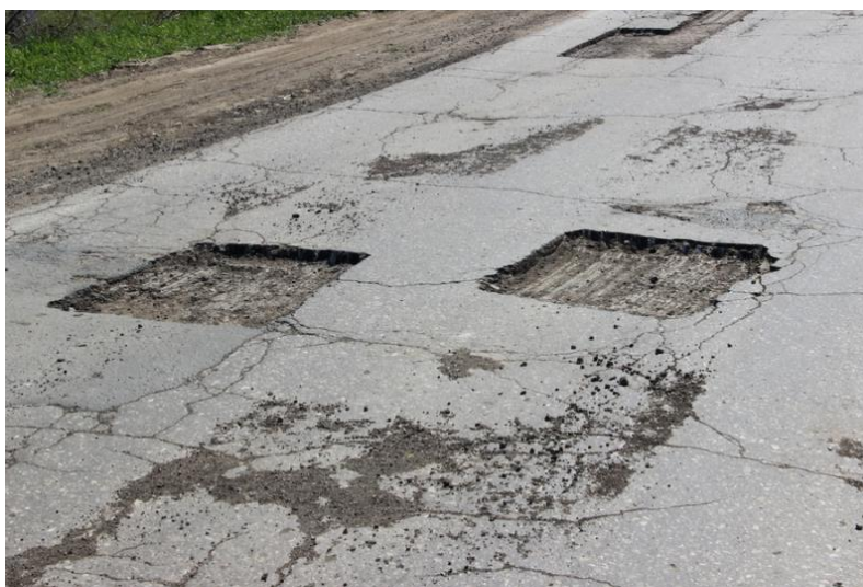
Рисунок 3. Фотография состояния дорожного покрытия с вырубленными картами (фото авторов)
