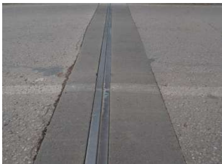
Рисунок 3. Несоответствие конструкции деформационного шва диапазону возможных перемещений сопрягаемых конструкций (разработано авторами)
