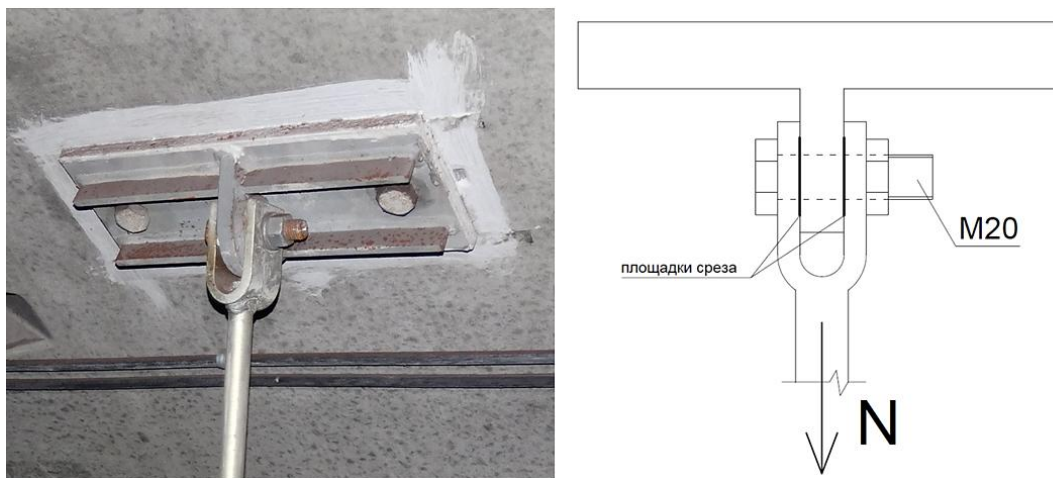
Рисунок 5. Узел крепления тяжа к обделке тоннеля и его схема (фото автора, составлено автором)
