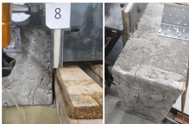
Рисунок 30. Трещина в основании правого бетонного блока (разработано авторами)
