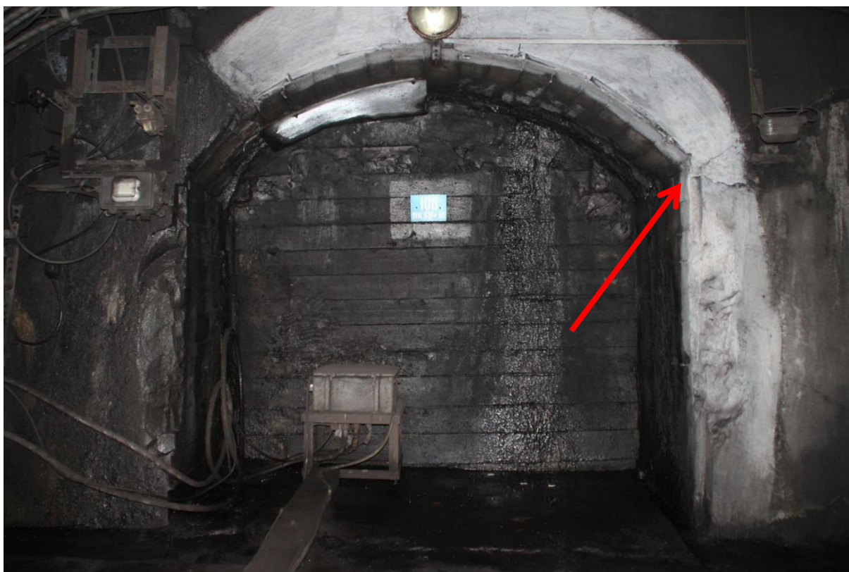
Рисунок 7. Трещины в нишах тоннеля транспортной зоны (фотографии авторов)
