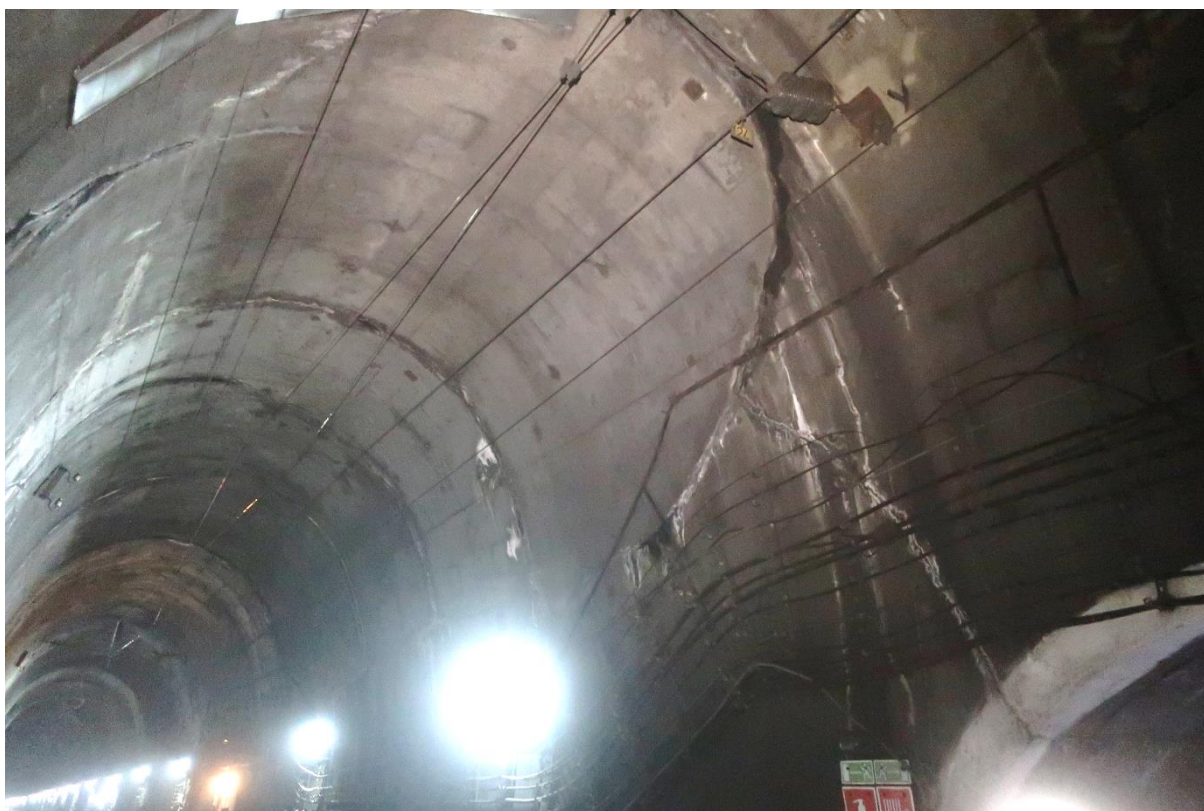
Рисунок 10. Наклонные трещины в обделке тоннеля транспортной зоны (фотография авторов)
